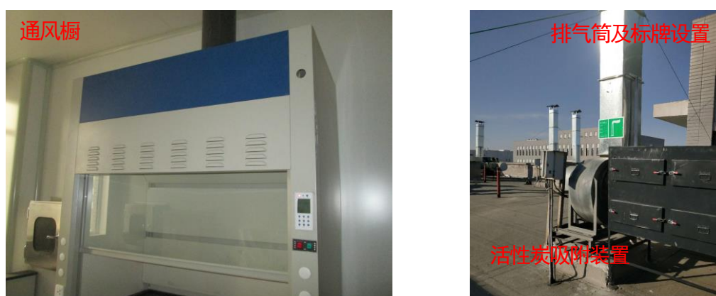
图 3-1 含酸、碱及挥发性化学物质的废气治理措施现场实施情况
