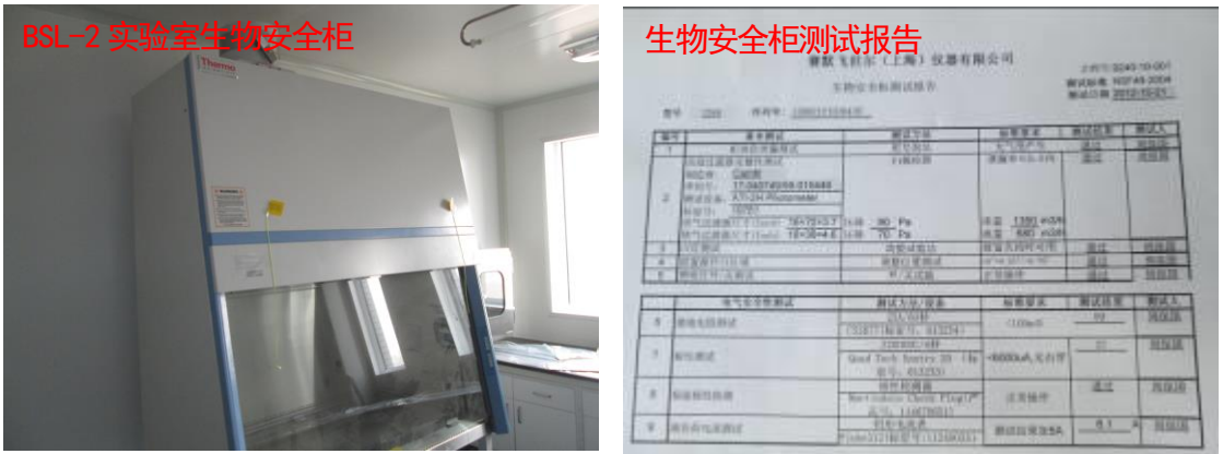
图 3-2 BSL-2 实验室含病原微生物废气治理措施现场实施情况
