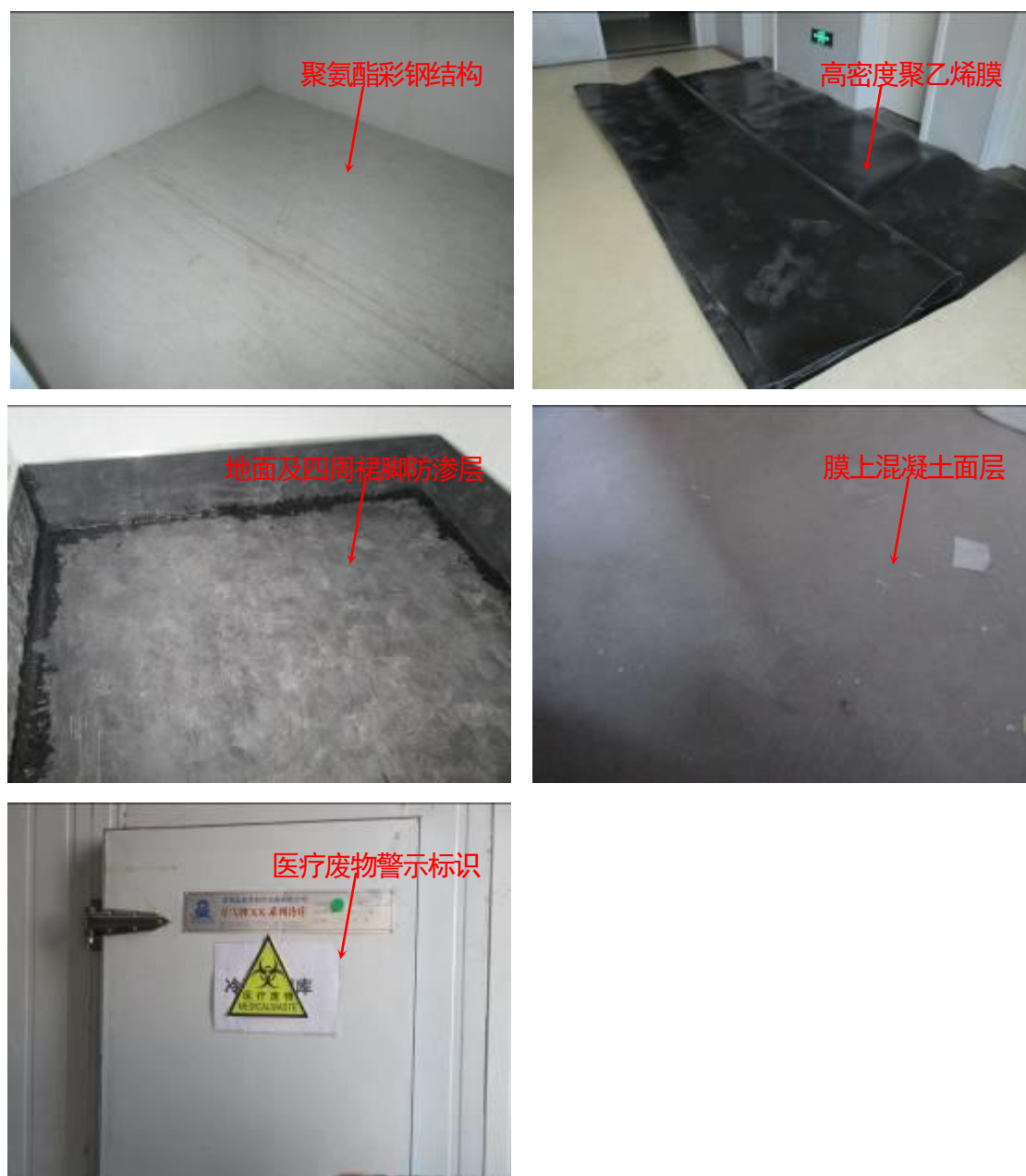
图 3-9 医疗废物暂存间现场实施情况
