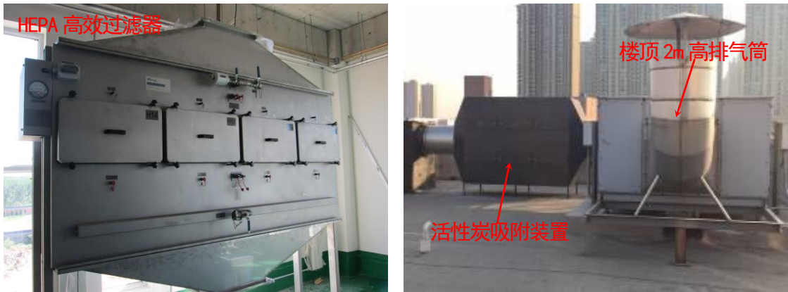
图 3-3 BSL-3 实验室和 ABSL-3 实验室废气治理措施现场实施情况
